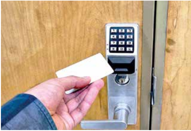
Рис. 7. Любая дверь внутри дата-центра должна быть защищена с помощью элементов СКД
