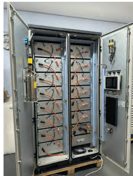
Рис. 12. Акумуляторна батарея великої потужності «Санрайз Буденерго»
