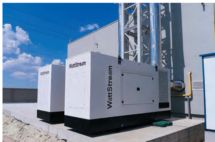
Рис. 7. Здвоєний генератор WattStream у логістичному центр
