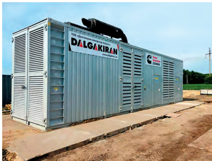
Рис. 6. Установка на базі ДГУ Cummins потужністю 2000 кВт, поставлена газовидобувній компанії
