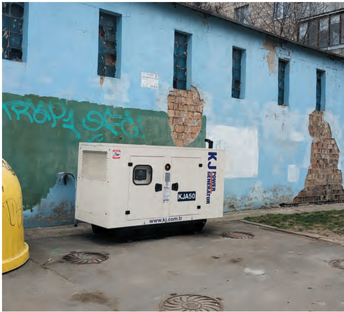
Рис. 1. Генератор KJ Power, встановлений взимку біля теплопункту
