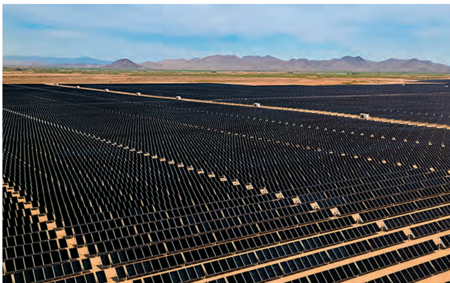
Рис. 5. Новая солнечная электростанция Sun Streams 2 установленной мощностью 200 МВт будет питать дата-центр Microsoft
