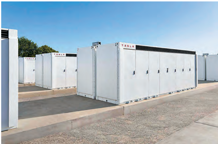
Рис. 6. Накопители энергии Tesla Megapack
