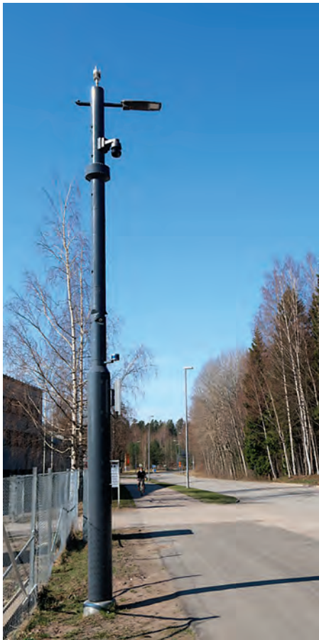
Рис. 6. Розумна опора освітлення Nokia LuxTurrim5G в Еспоо (Фінляндія)
