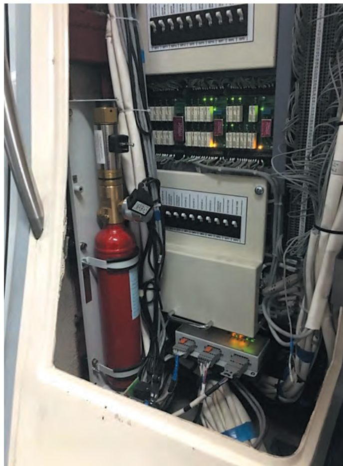
Рис. 5. Автономная система пожаротушения в электрическом шкафу
