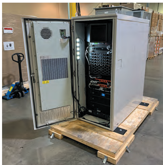
Периферийные дата-центры на основе микроЦОД вскоре могут стать неотъемлемой частью Smart City
