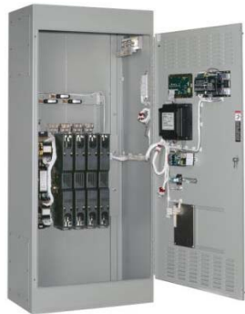
Устройства Автоматического Ввода Резерва (АВР)
