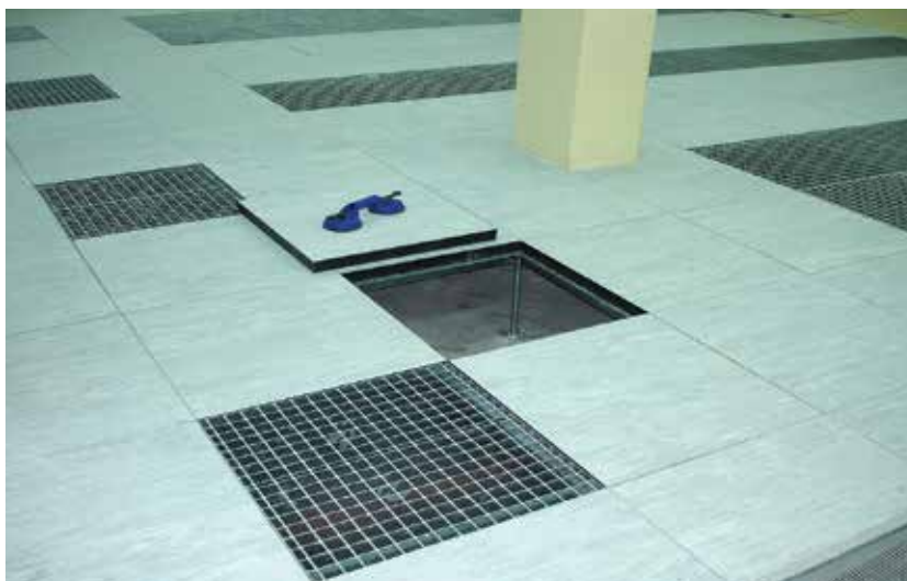
Рис. 3. Серверное помещение с фальшполом NOVAPOL
