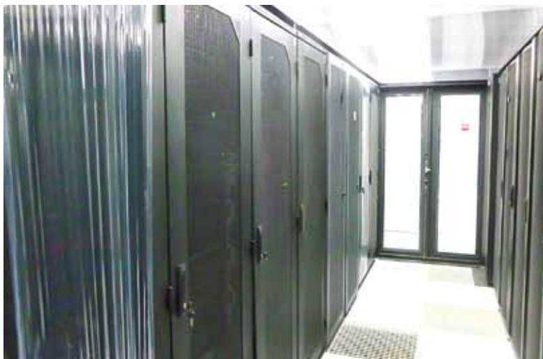
Рис. 18. Серверные шкафы Alfastar компании «Евроформат», установленные в дата-центре BeMobile
