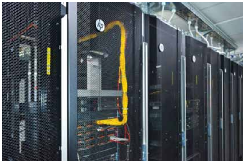
Рис. 8. Шкафы HP, установленные в ЦОД United DC
